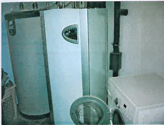
technická místnost - zásobník tepelného čerpadla
