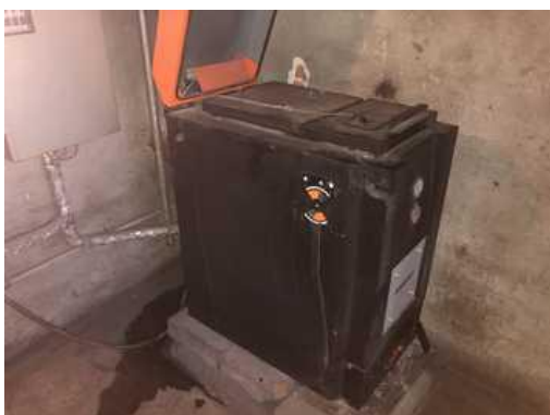
Prostor 1. PP - kotel na pevná paliva
