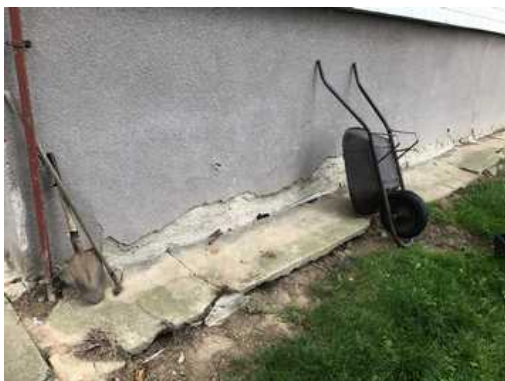
Stav 1. PP - vliv zatékání
