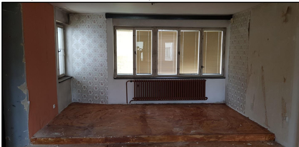
Zdroj: Fotografie pořízená znaleckým ústavem na místě šetření
