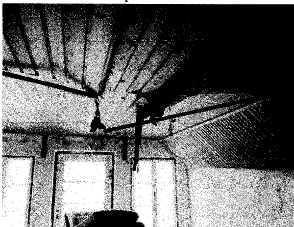
Poškozeny konstrukce stropu
