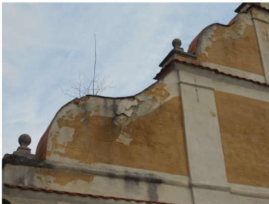
Zatékání do štítu budovy
