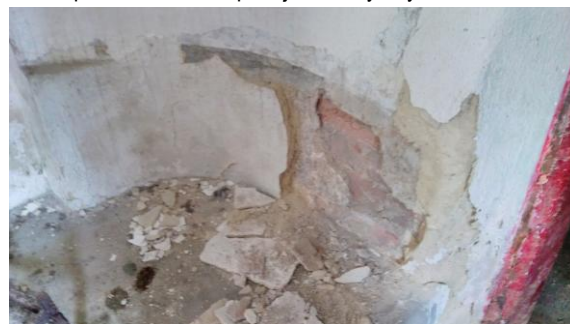
pohled na opadávající omítku a zdivo v prostorech 1.NP
