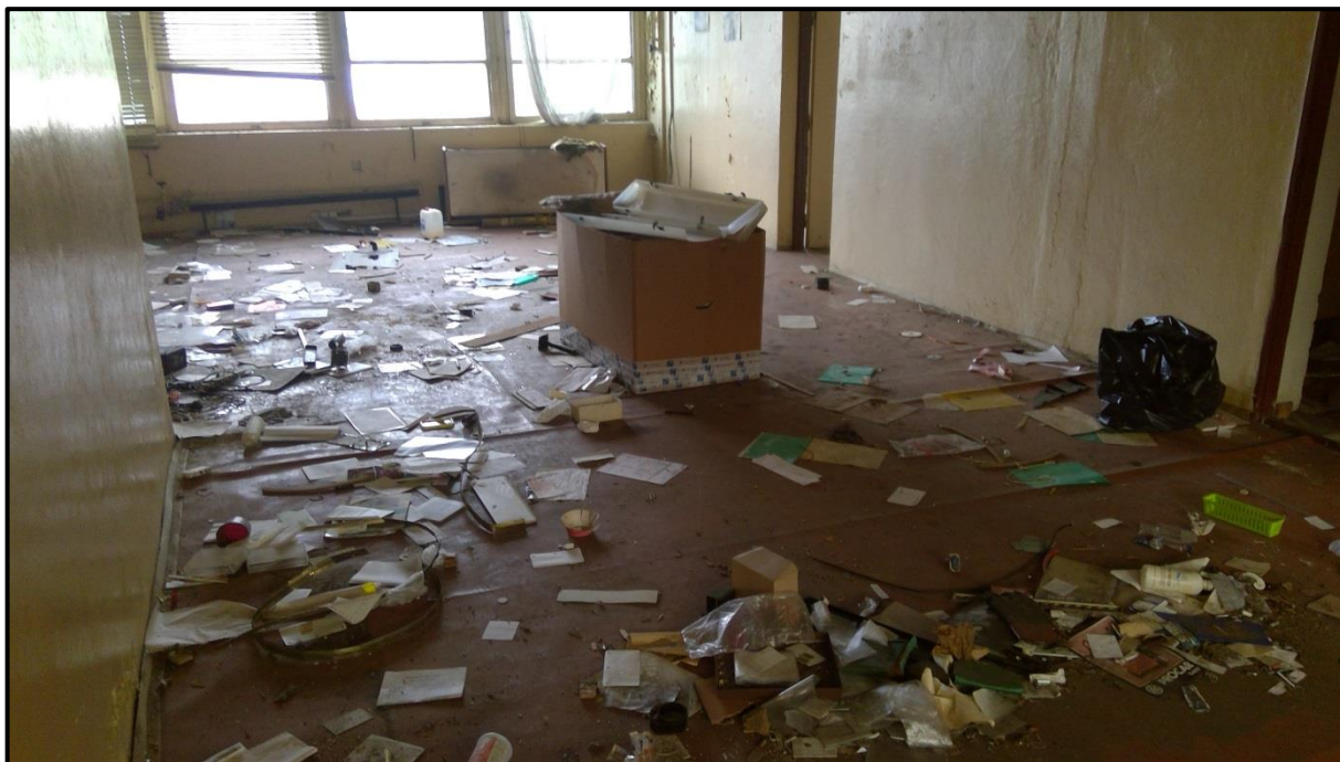
Fotodokumentace pořízená znaleckým ústavem na místním šetření
