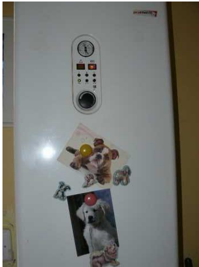
el. kotel ÚT
