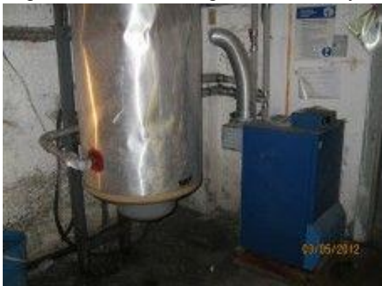
interiér suterén kotel ÚT
