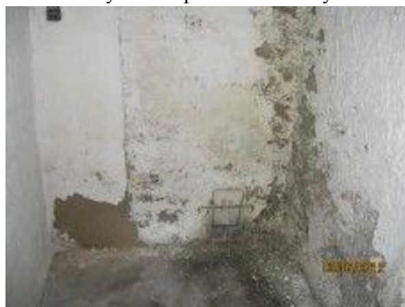
detail vlhkost zdiva v suterénu
