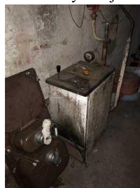
Kotel na vytápění
