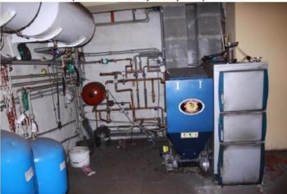
Dům č.p. 1372 - kotelna
