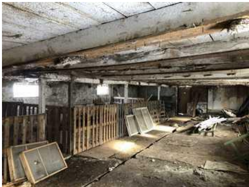
Interiér budovy-špatný stav
