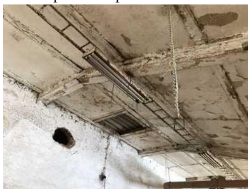
Interiér budovy-zatékání střechou
