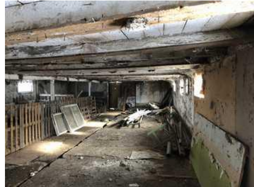
Interiér budovy-špatný stav
